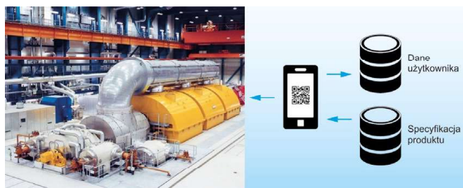
Rys. 3. Przykładowy zespół maszynowy – turbogenerator i jego otoczenie
